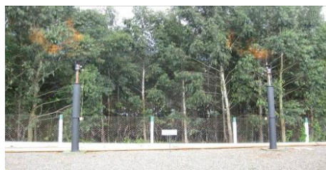
Figura 11- Queimadores de gás
