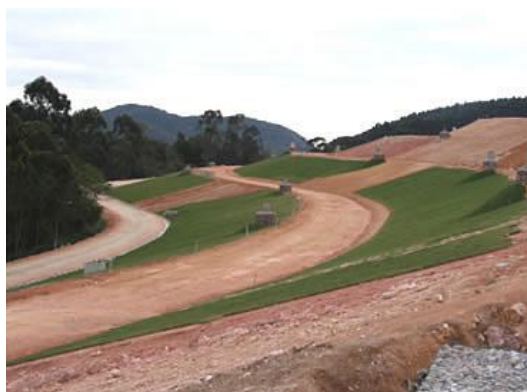
Figura 2 - Vista parcial da frente de serviço do Aterro. (Fonte: Proactiva Meio Ambiente Brasil Ltda).
