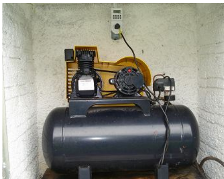
Figura 4 - Compressor de ar.
