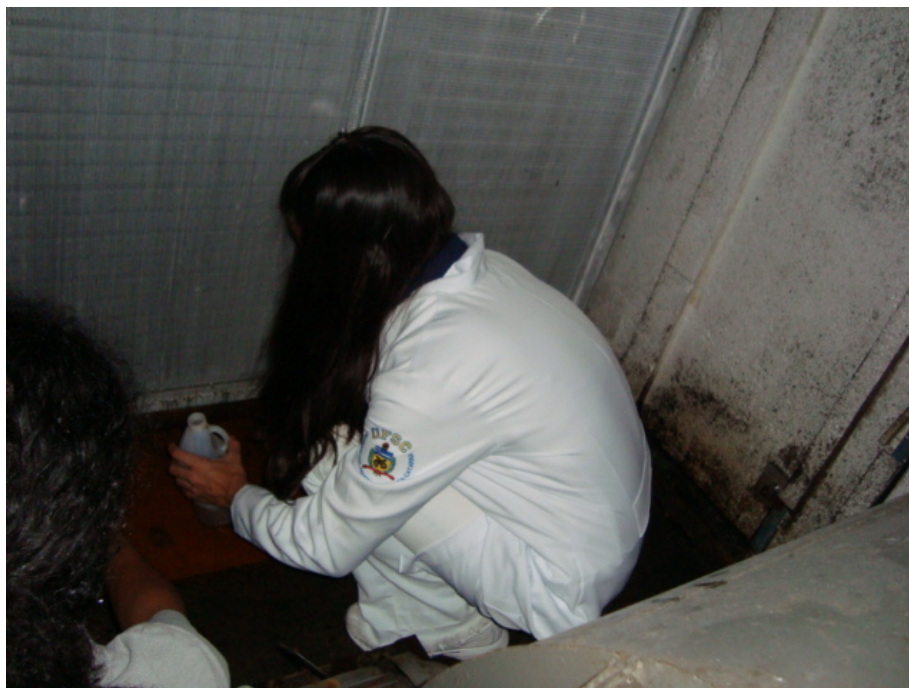
Figura 14: Coleta de amostra na bandeja de condensado do Hospital A.
