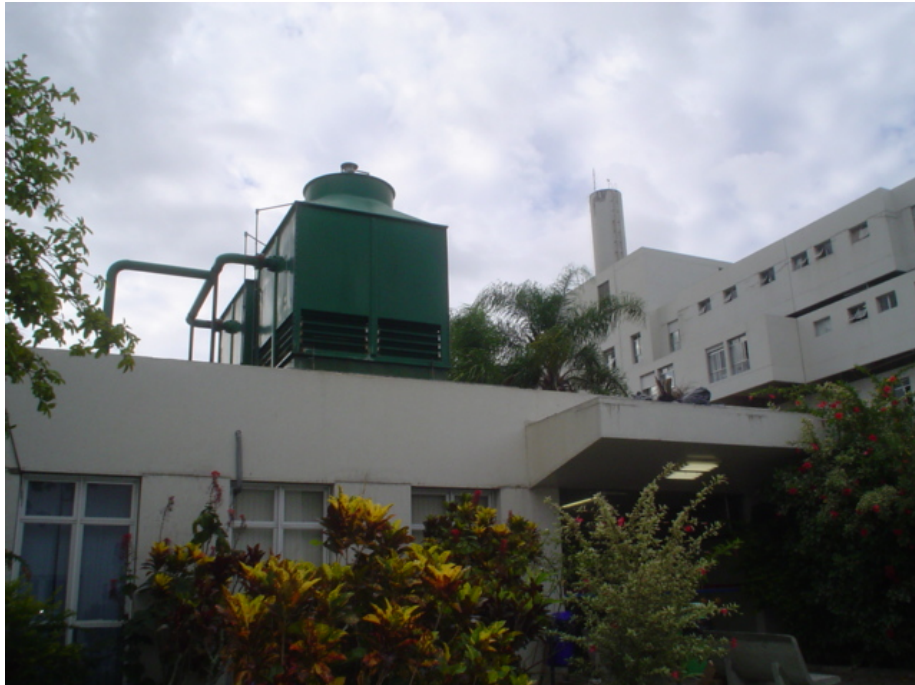
Figura 9: Torre de resfriamento de água do hospital A.
