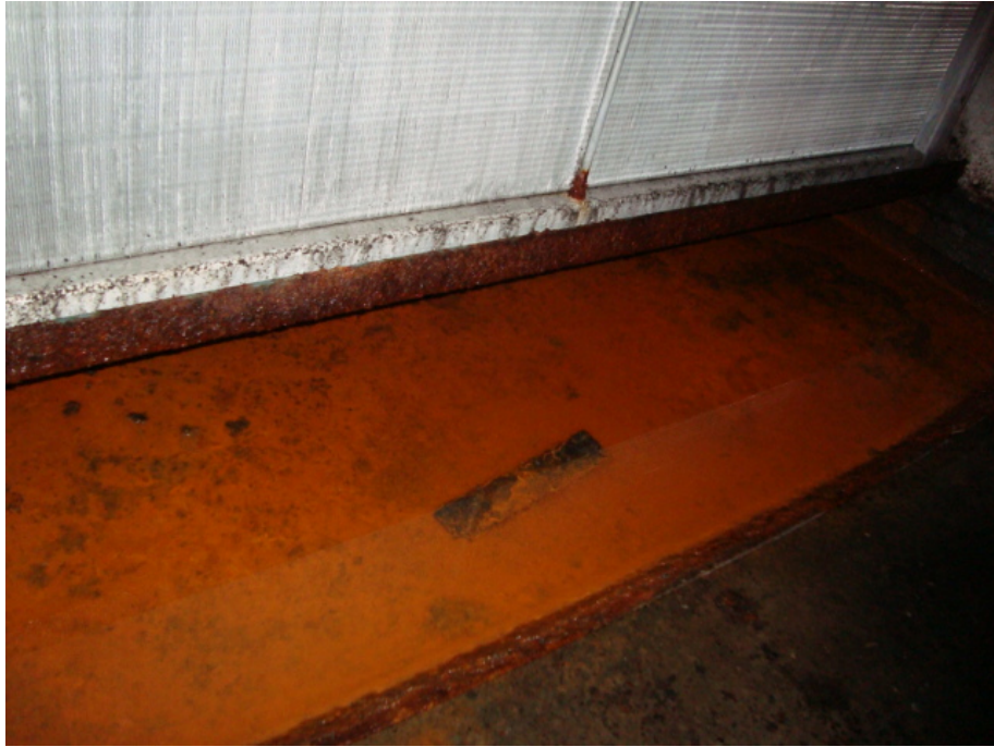
Figura 11: Bandeja do condensado do Hospital A.
