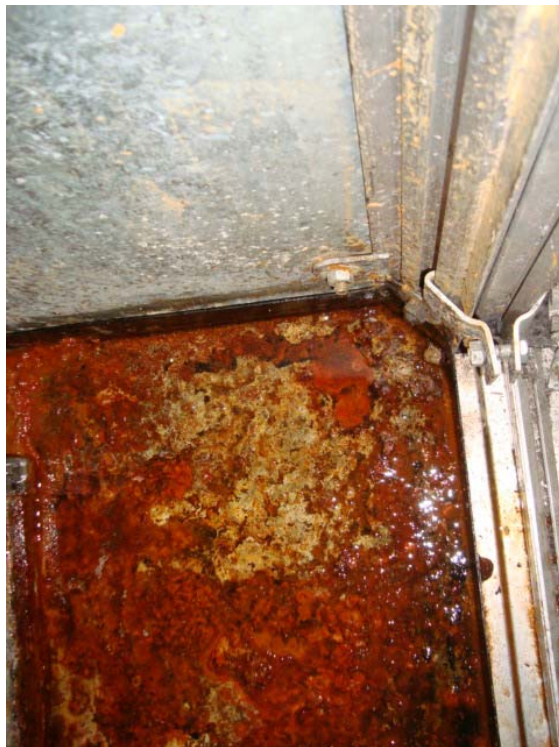
Figura 12: Bandeja do condensado do Hospital B.
