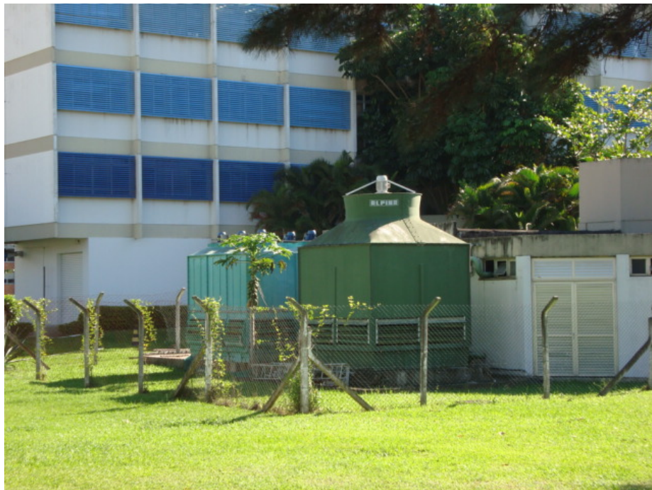
Figura 5: Exemplo de torre de resfriamento no campus da UFSC.
