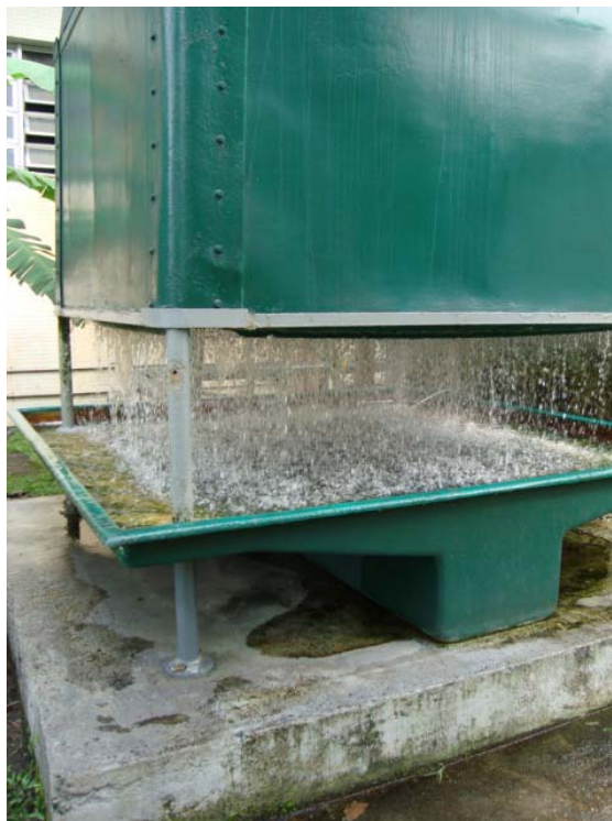
Figura 10: Torre de resfriamento de água do hospital B.
