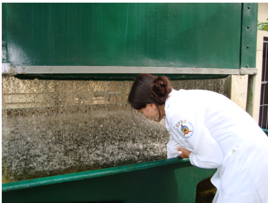
Figura 15: Coleta de amostra na torre de resfriamento do Hospital B.
