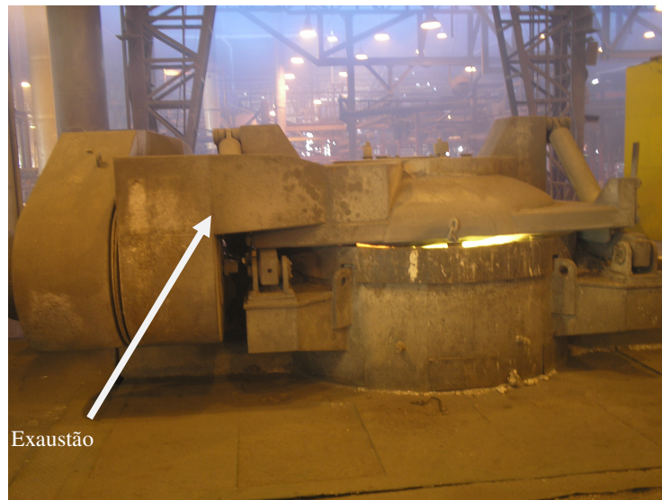
Figura 8 – Forno com a tampa fechada.
