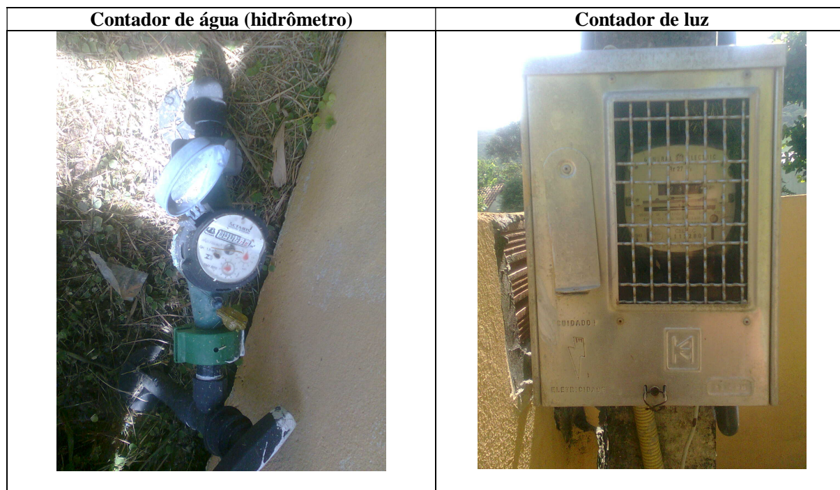
Figura 2 - FOTO DOS CONTADORES DE ÁGUA E ENERGIA ELÉTRICA DA RESIDÊNCIA DA “FAMÍLIA2”.
