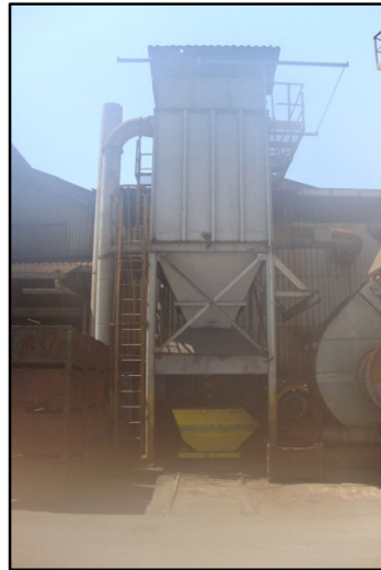
Figura 8: Sistema de Controle de Poluentes nº 04.
