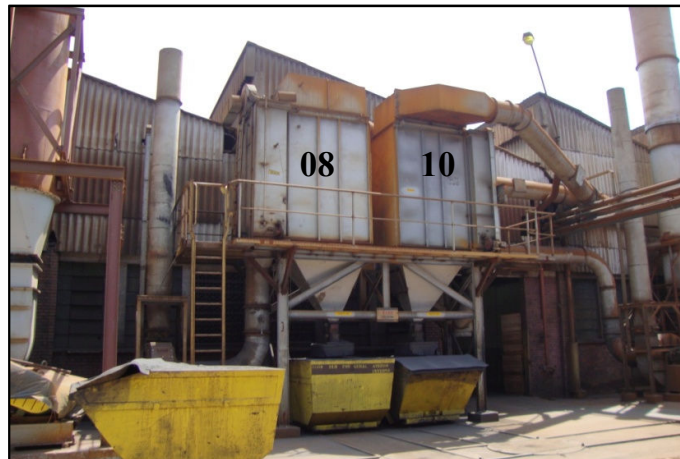
Figura 13: Sistema de Controle de Poluentes nº 08 e 10.
