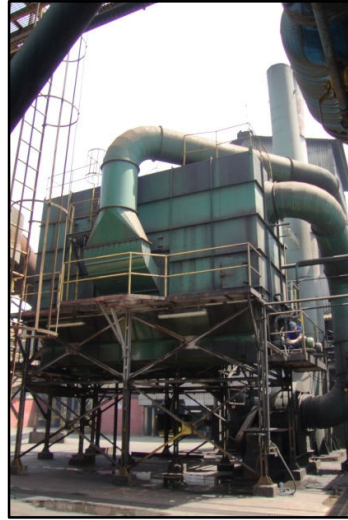
Figura 6: Sistema de Controle de Poluentes nº 02.
