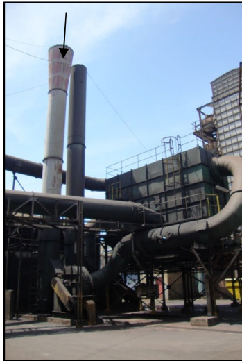
Figura 7: Sistema de Controle de Poluentes nº 03.
