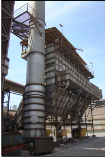
Figura 5: Sistema de Controle de Poluentes nº 01.
