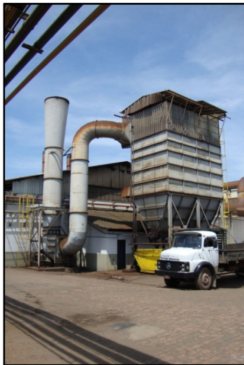
Figura 9: Sistema de Controle de Poluentes nº 05.
