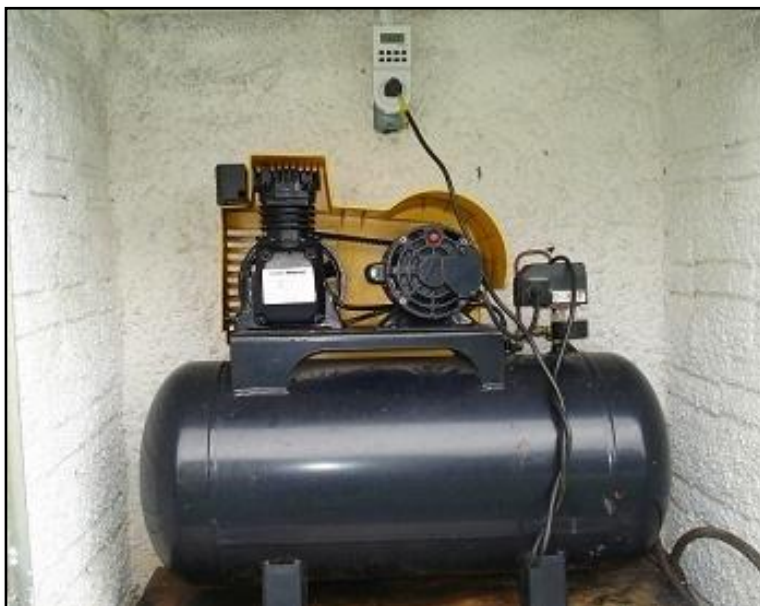
Figura 5 - Compressor de Ar (2008).
