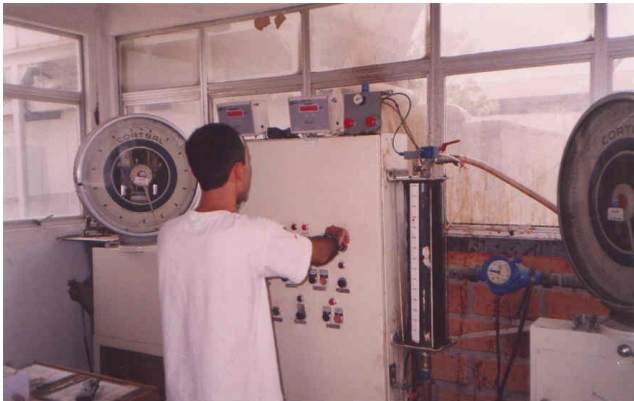
Figura 2.3 – Controle manual de uma central de concreto
