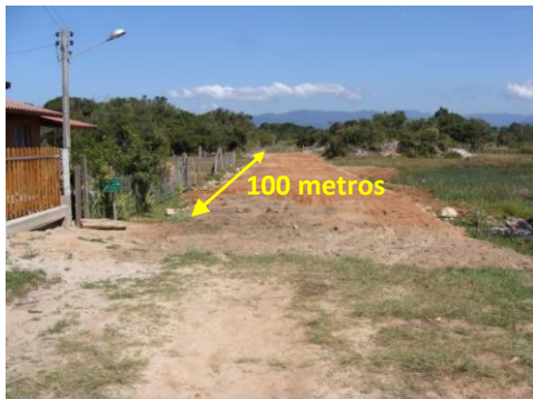
Figura 7. Ampliação da via com depósito de aterro no sentido oeste-leste em 16/09/10. Fonte: autor.
