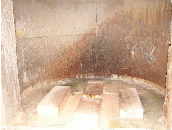
Figura 5.25 - Fotografia mostrando a abrangência da chama na parede interna do forno.
