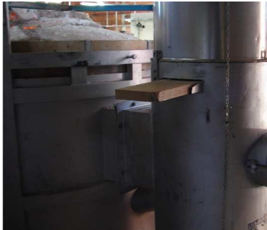
Figura 3.4 - Fotografia mostrando a tubulação de exaustão dos gases, guilhotina de controle e início do recuperador de calor.
