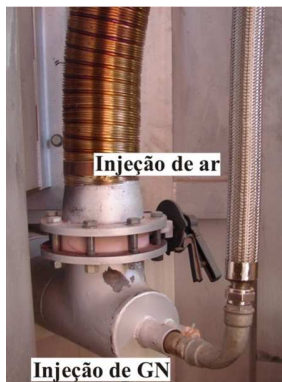
Figura 3.8 - Fotografia do queimador - parte externa ao forno.
