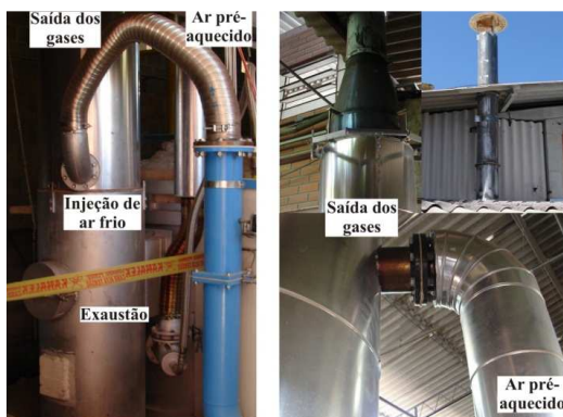
Figura 3.7 - Fotografias com detalhes do recuperador de calor.
