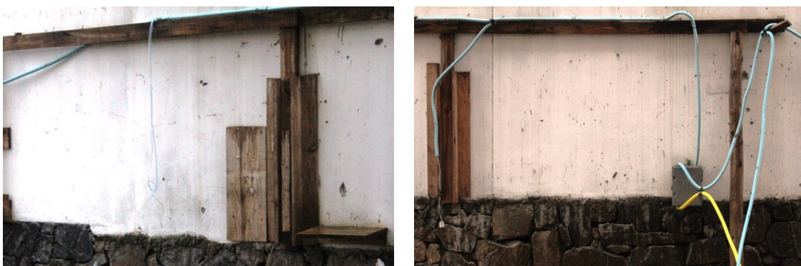
Figura 10 - Instalações elétricas Fonte: Arquivo pessoal
