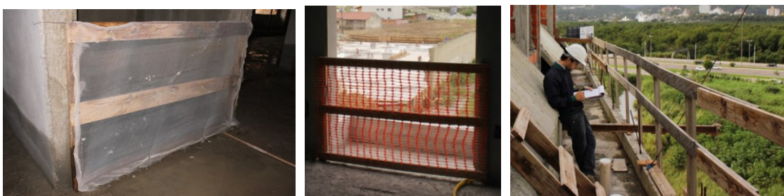
Figura 42 - Proteção coletiva contra queda de altura Fonte: Arquivo pessoal
