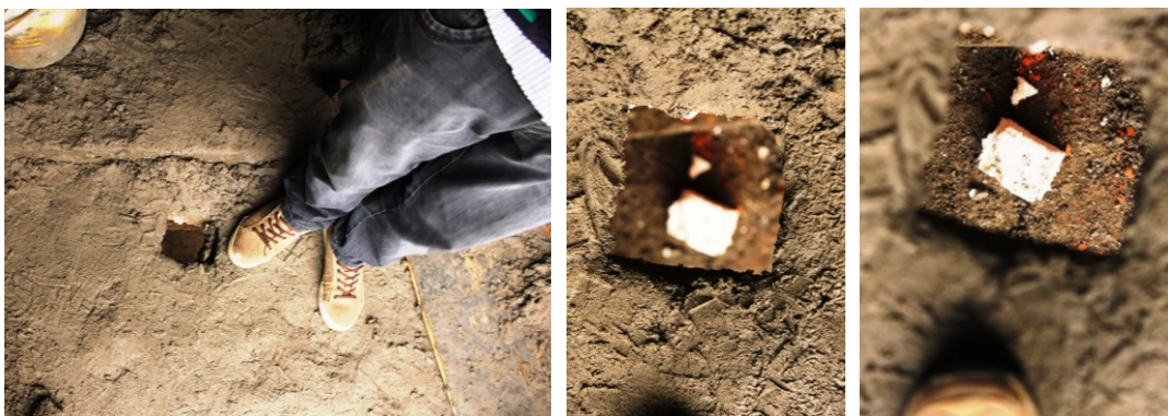
Figura 41 - Aberturas no piso sem proteção Fonte: Arquivo pessoal
