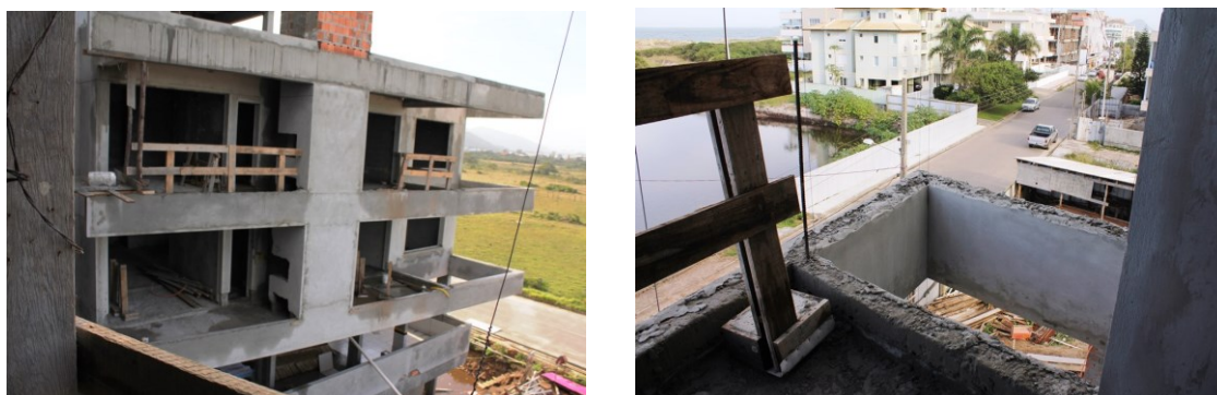
Figura 25 – Guarda-corpo ineficiente Fonte: Arquivo pessoal
