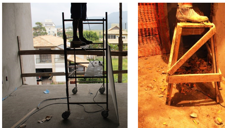
Figura 5 - Registros da falha na proteção coletiva Fonte: Arquivo pessoal
