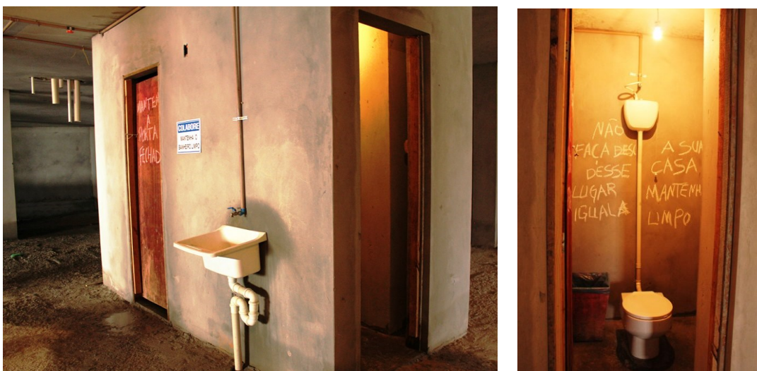
Figura 36 - Vasos sanitários e lavatório Fonte: Arquivo Pessoal
