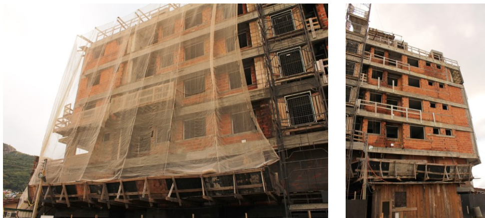
Figura 43 - Tela de proteção Fonte: Arquivo pessoal
