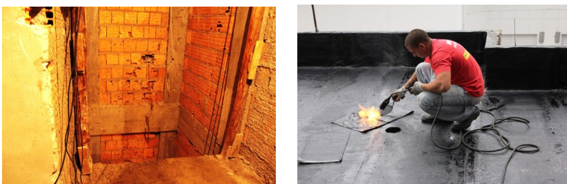
Figura 6 - Registros da falta de proteção coletiva Fonte: Arquivo pessoal
