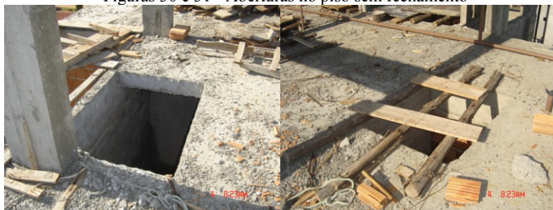
Figuras 30 e 31 - Aberturas no piso sem fechamento
