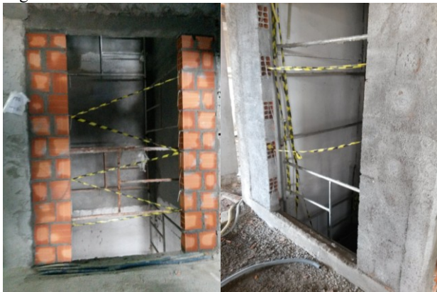
Figuras 36 e 37 - Abertura do vão do elevador não conforme
