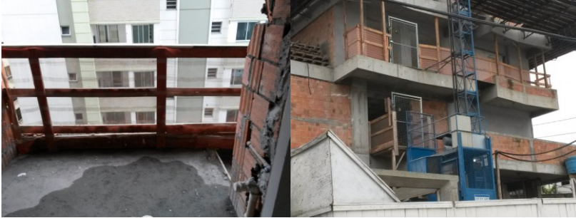
Figuras 40 e 41 - Sistema guarda-corpo-rodapé conforme
