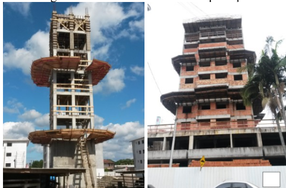
Figuras 46 e 47 – Plataformas de proteção
