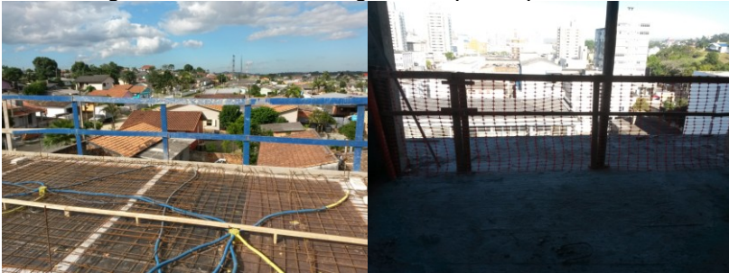
Figuras 42 e 43 - Sistema de guarda-corpo-rodapé não conforme
