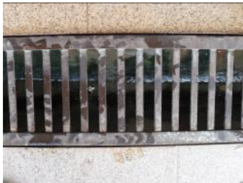
Figura 24: Grades atuais na área de recepção com espaçamento de 2 cm.
