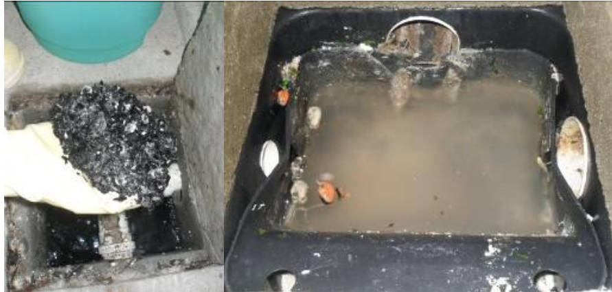
Figura 11: Caixa de inspeção e caixa de gordura.
