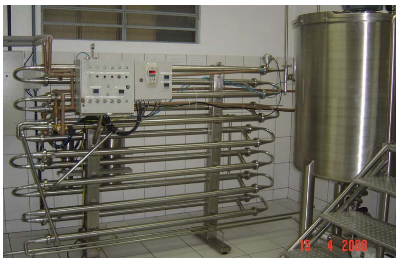
Figura 3: pasteurizador multitubular (centro) e tanque pulmão (à esquerda).
