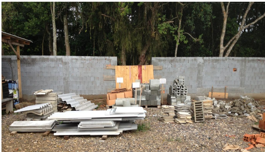
Figura 32 - Materiais soltos e sem identificação no canteiro antes do 5S. Fonte: Acervo da autora.
