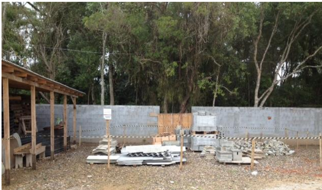
Figura 37 - Isolamento da área dos materiais que não estão sendo usados na obra. Fonte: acervo da autora.
