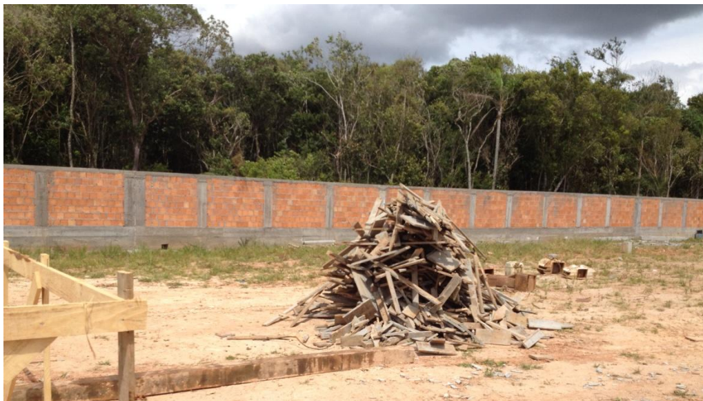
Figura 13 - Entulhos na obra antes da aplicação do 5S. Fonte: Acervo da autora.
