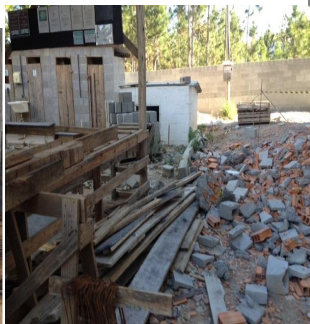
Figura 6 - Resíduos soltos pelo canteiro de obra da empresa Y. Fonte: Acervo da autora.
