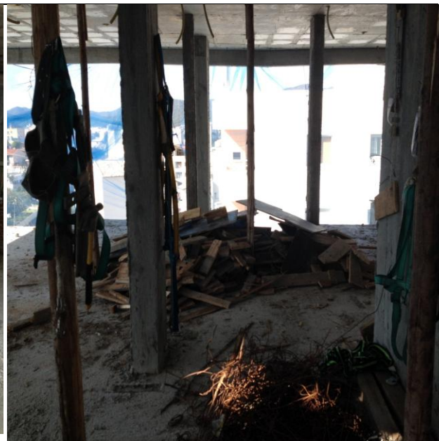
Figura 4 - Sobras de materiais soltos pela obra da empresa X. Fonte: Acervo da autora.
