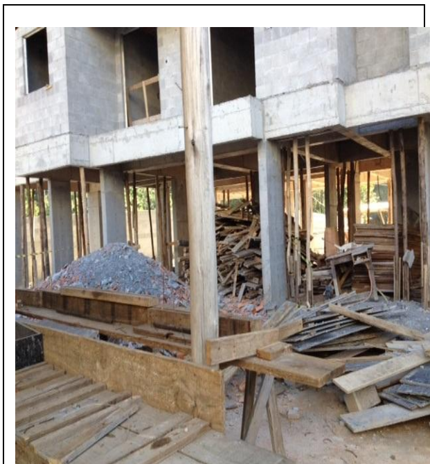
Figura 7 - Resíduos soltos pelo canteiro de obra da empresa Y. Fonte: Acervo da autora.
