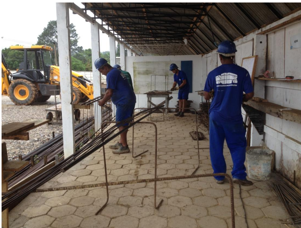
Figura 46 - Central de armadura durante o dia. Fonte: Acervo da autora.
