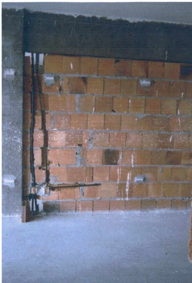
Figura 3- Quebras realizadas nas paredes do sistema convencional devido à falta de detalhamentos dos projetos.
