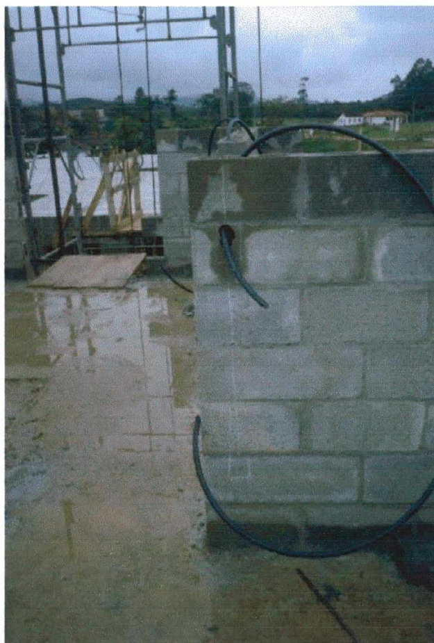
Figura 1- Deficiência de coordenação e detalhamentos dos projetos em alvenaria estrutural (Projeto Elétrico)
