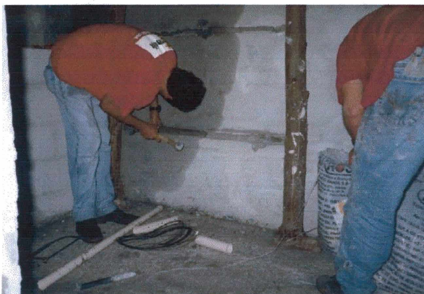
Figura 2- Deficiência de coordenação e detalhamentos dos projetos em alvenaria estrutural (Projeto Hidráulico)
