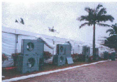
Figura 7: Aparelhos de ar-condicionado da lona do almoço
