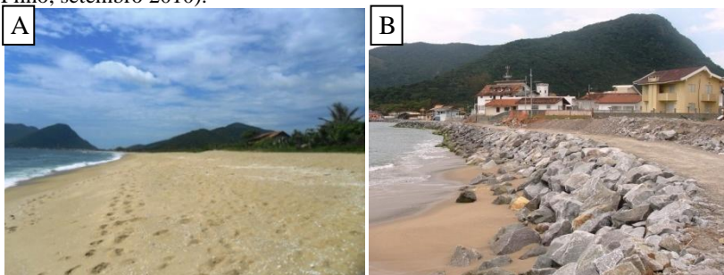
Figura 31 – Vista para sul da praia da Armação em ponto não atingido pelo evento erosivo (A) e ponto atingido com construção de obra de contenção (B) (Foto A: Marinês da Silva, dezembro 2012; foto B: Norberto Olmiro Horn Filho, setembro 2010).
