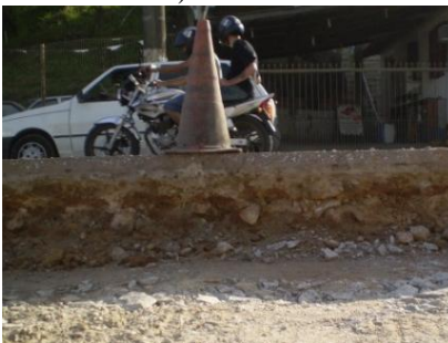
Figura 12 – Recorte na rodovia SC-406 onde pode ser observada a deposição de material espólico na base do capeamento asfáltico (Foto: Marinês da Silva, dezembro 2011).
