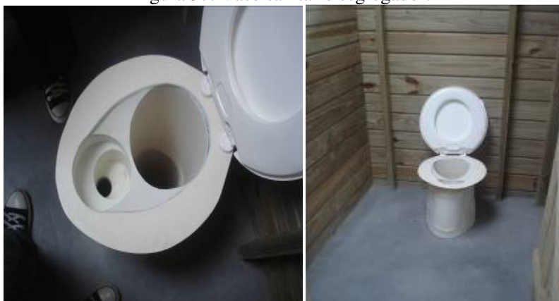
Figura 37: Vaso sanitário segregador.
