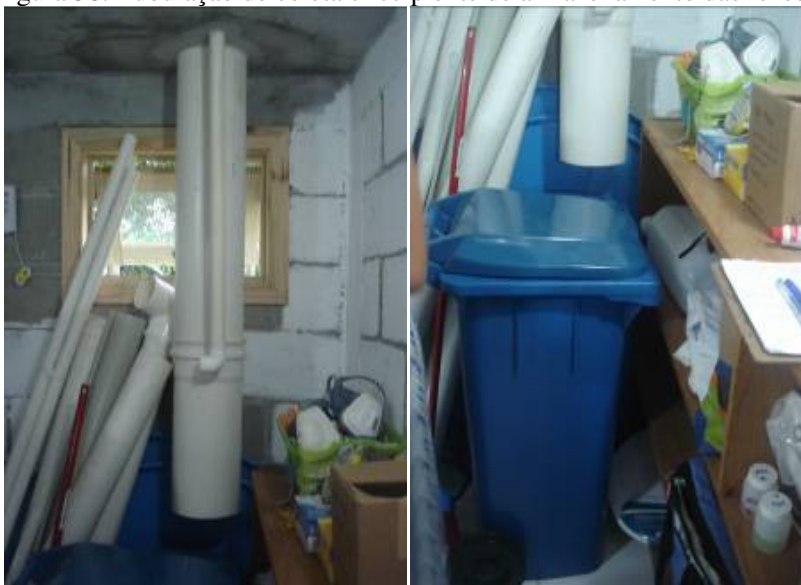
Figura 38: Tubulação de coleta e recipiente de armazenamento das fezes.
