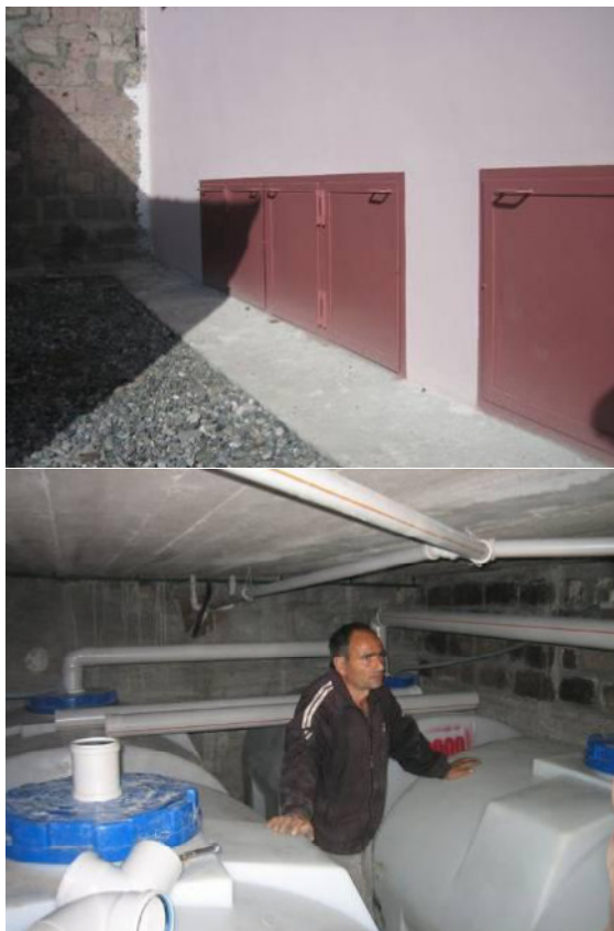
Figura 56: Câmaras dos sanitários e os tanques para armazenamento da urina.
