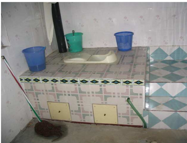
Figura 49: Imagem do sanitário implantado.
