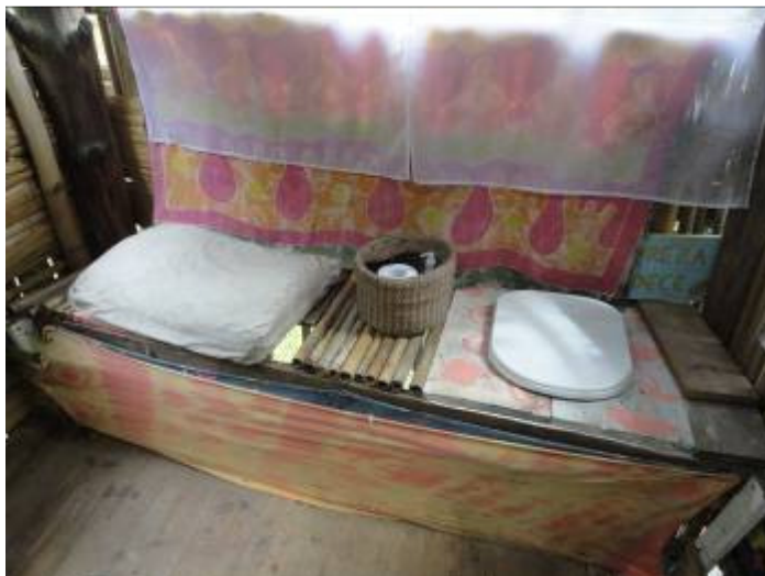
Figura 43: Vista interna do sanitário com a tubulação de separação da urina e fezes.
