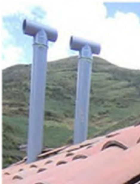
Figura 59: Tubulação de ventilação com sistema que impede a entrada da chuva.
