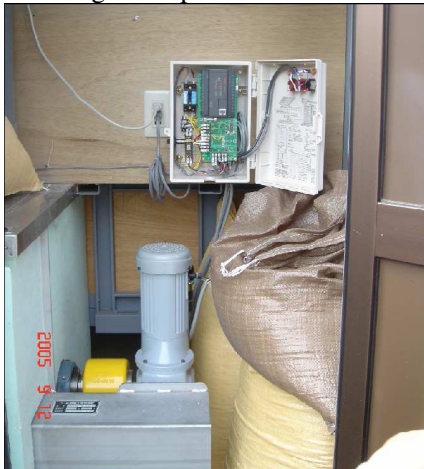
Figura 28: O sistema de controle das partes automatizadas e armazenagem de serragem na parte de trás dos banheiros portáteis.
