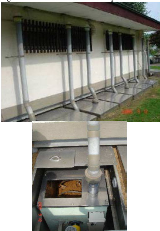
Figura 27: Detalhe dos reatores permanentes.
