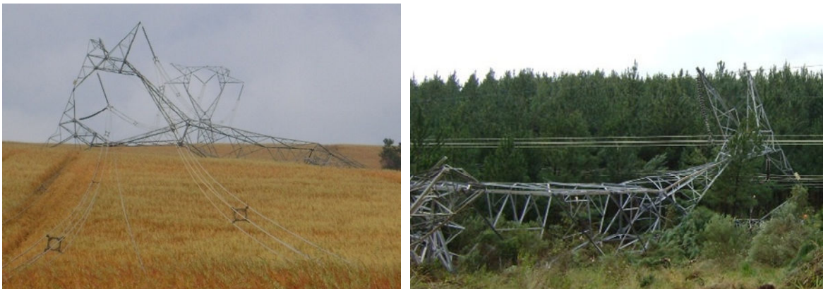
Figura 6.14: Torres caídas da LT Ivaiporã - Areia em 08/09/2009 – Fonte: Eletrosul.
