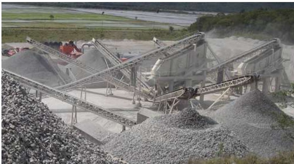
Figura 2.10 – Decks de peneiramento e pilhas de material pronto para comercialização (centro esquerdo) e material para re-britagem (canto direito inferior).
