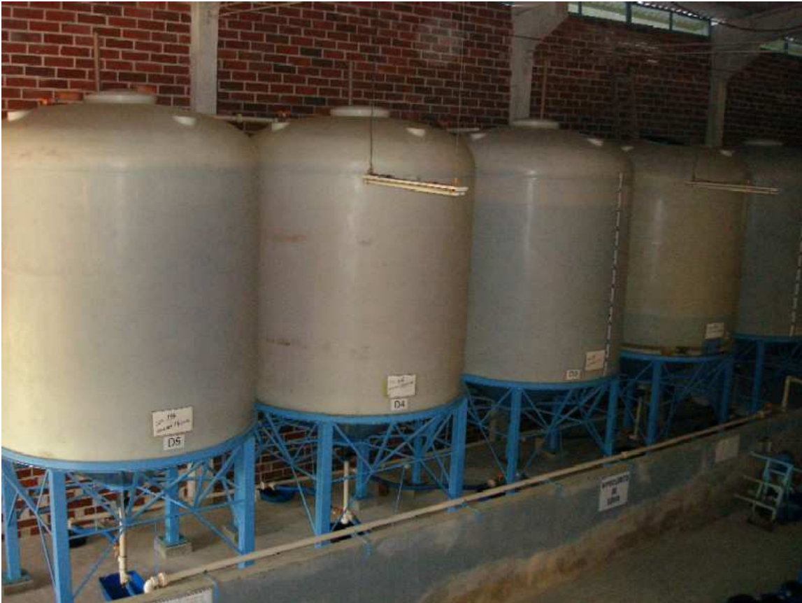
Figura 8. Foto dos decantadores no interior da fábrica.
