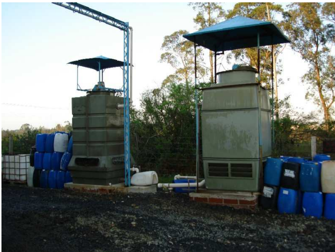
Figura 5. Foto das torres de resfriamento no exterior da fábrica.
