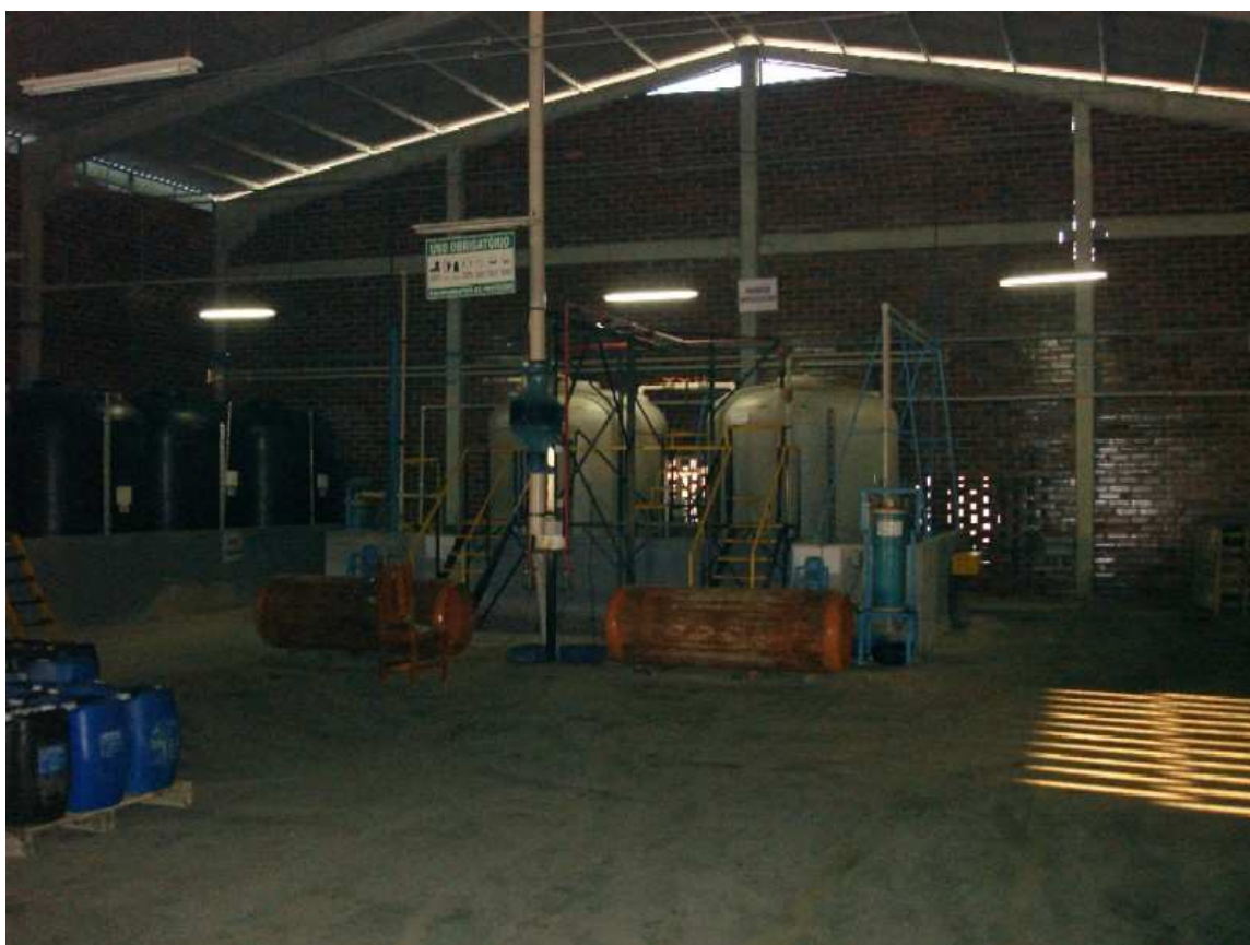
Figura 4. Foto dos reatores no interior da Fábrica.
