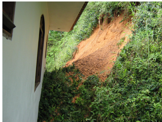
Figura 6.44 – Material deslizado que atingiu a residência. Observar a proximidade da casa em relação ao corte. Foto: Prefeitura Municipal Antônio Carlos, 26 mar. 2010.
