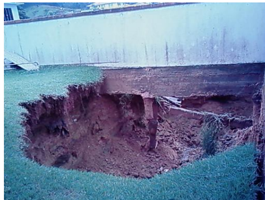
Figura 6.46 – Rompimento da tubulação pluvial que abriu um buraco de 4 m. de diâmetro sob o muro de uma residência na Avenida João Antônio Besen. Foto: Altamiro A. Kretzer, 26 mar. 2010.
