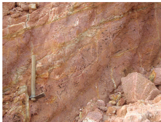
Figura 5.5 – Manto de alteração intensamente fraturado, em dois planos visíveis. Foto: Solange R. Wilvert, 17 abr. 2010.
