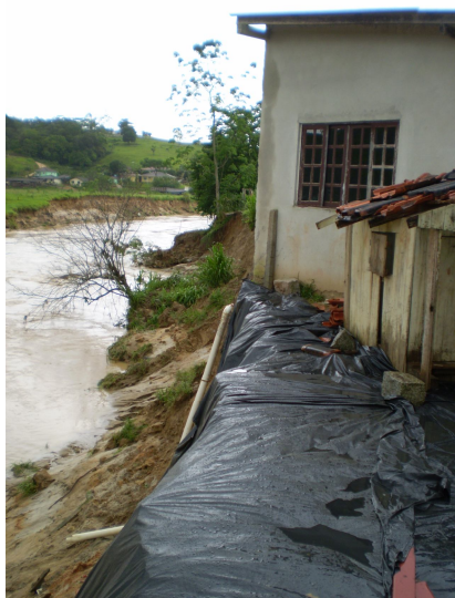
Figura 6.34 – Destruição parcial de uma residência na Rua Vereador Osvaldino Hoffmann, na área urbana. Foto: Prefeitura Municipal de Antônio Carlos, 25 de nov. 2008.
