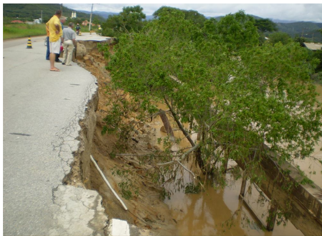
Figura 6.30 – Erosão fluvial da margem direita do Rio Biguaçu na Avenida João Frederico Martendal. Foto: Solange R. Wilvert, 01 fev. 2008.
