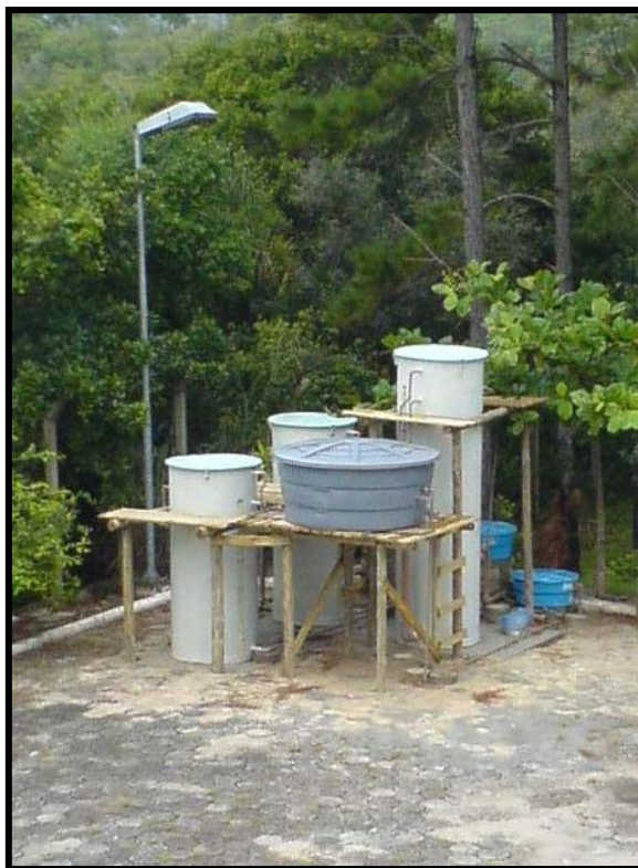
Figura 12 - Foto do conjunto dos três sistemas piloto de tratamento por filtração lenta
