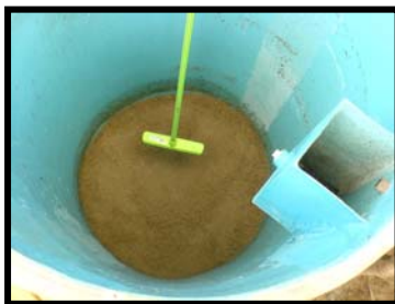
Figura 23 - Foto do interior do filtro FLC
