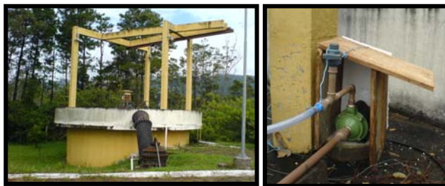
Figura 8 - Poço de captação e bomba centrífuga
