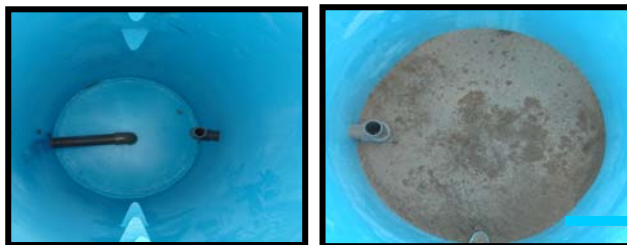
Figura 24 - Foto do interior do filtro FLR
