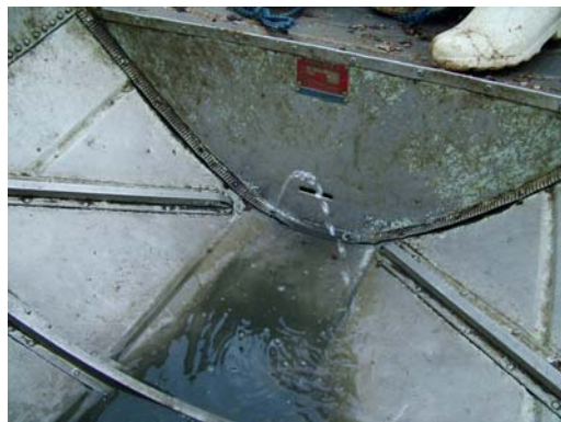
Figura 2.14 – Flagrante de vazamento no casco de um barco construído com uso de rebites de alumínio.
