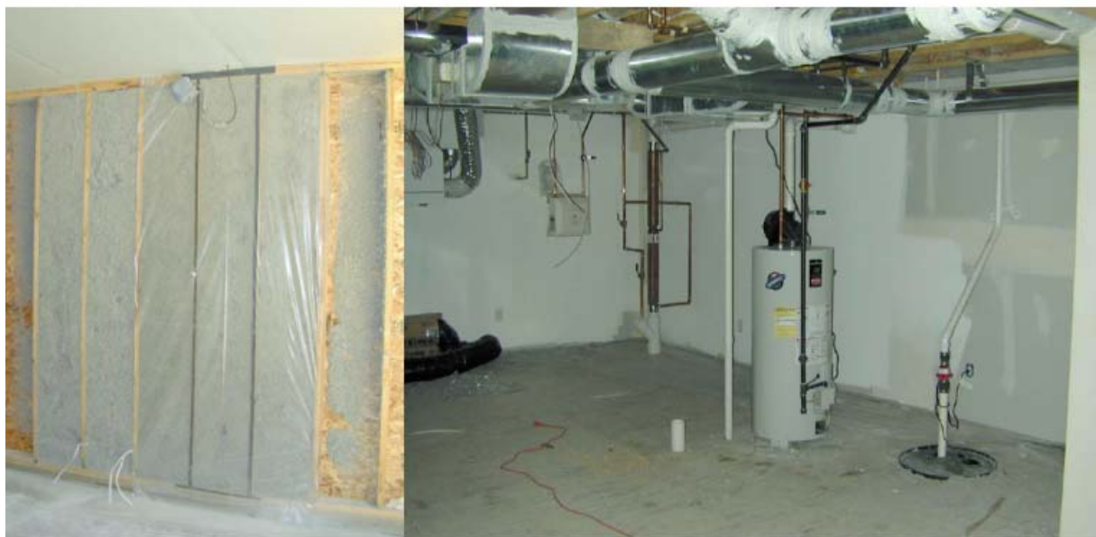
Figura 5 – Isolamento Térmico-acústico e Sistema de Calefação.
