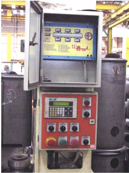
Figura 4.35 - Painel de controle.
