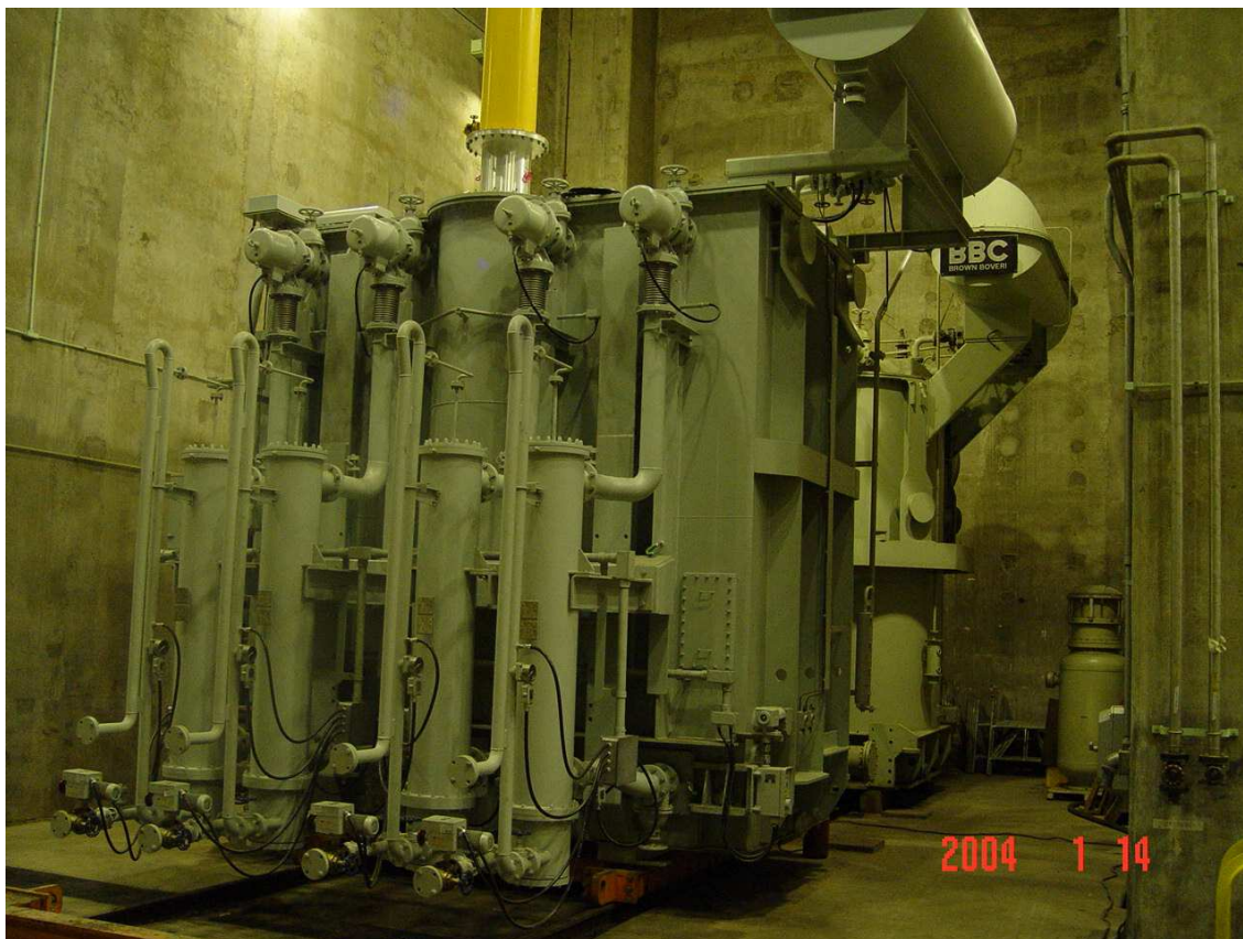
Figura 20. Transformador 525 kV, 50 Hz, 265 MVA monofásico
