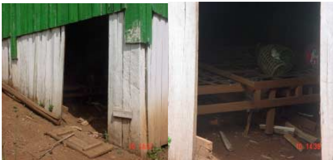
Fonte: A partir dos dados primários da pesquisa, 2004. Figura 17 - Foto do porão da residência de JB , em Vila Nova, no Município Seara, Estado de Santa Catarina.
