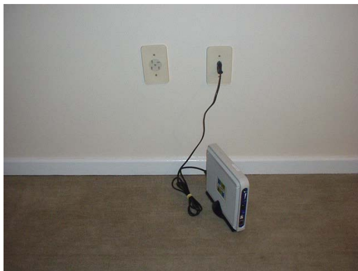
Figura 5.2 - Equipamento primário PLC (master) instalado no cenário residencial
