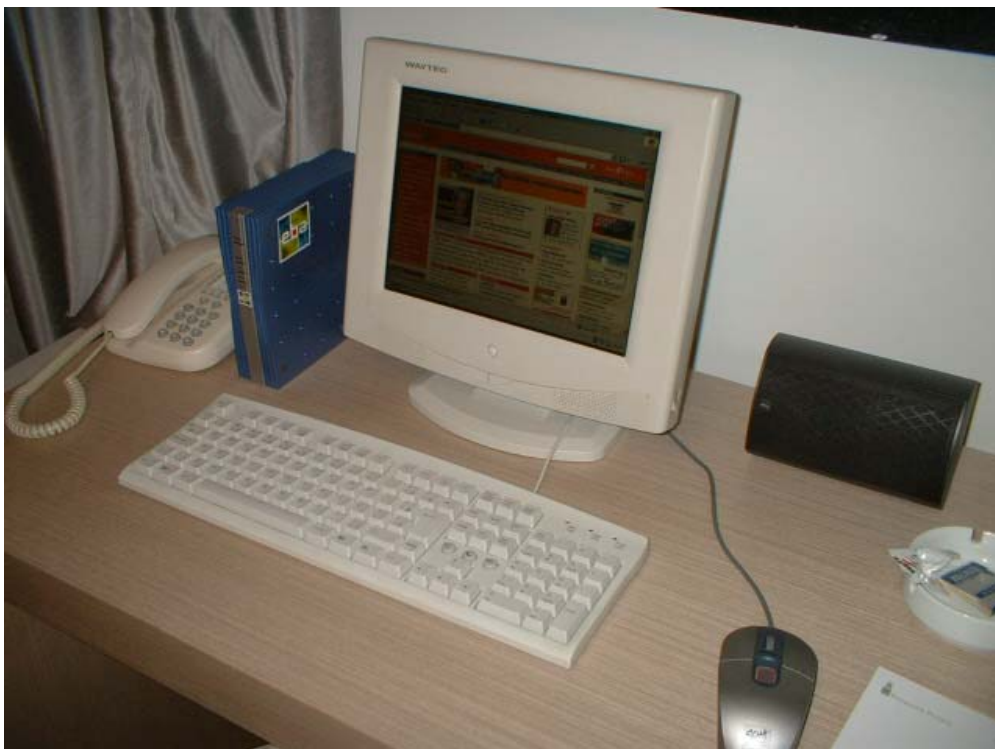
Figura 2.11 - MODEM PLC instalado em cliente residencial.
