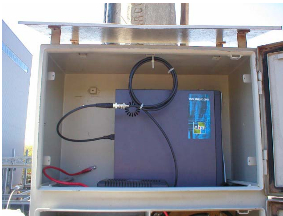
Figura 2.8 - Detalhe do equipamento primário no abrigo metálico.
