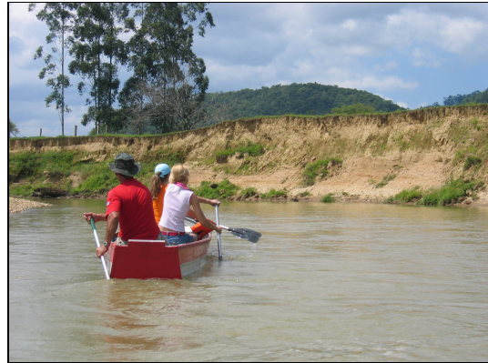
Figura 47: Erosão no Rio Itajaí-Mirim.
