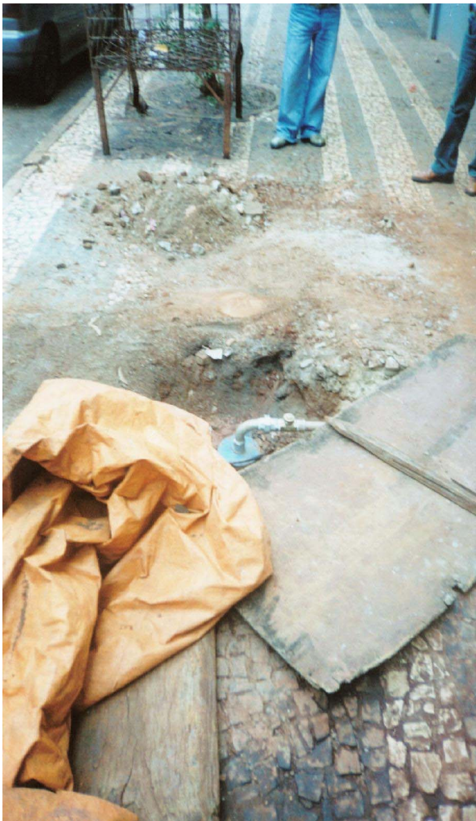
Edifício Premier II – Poço danificado
