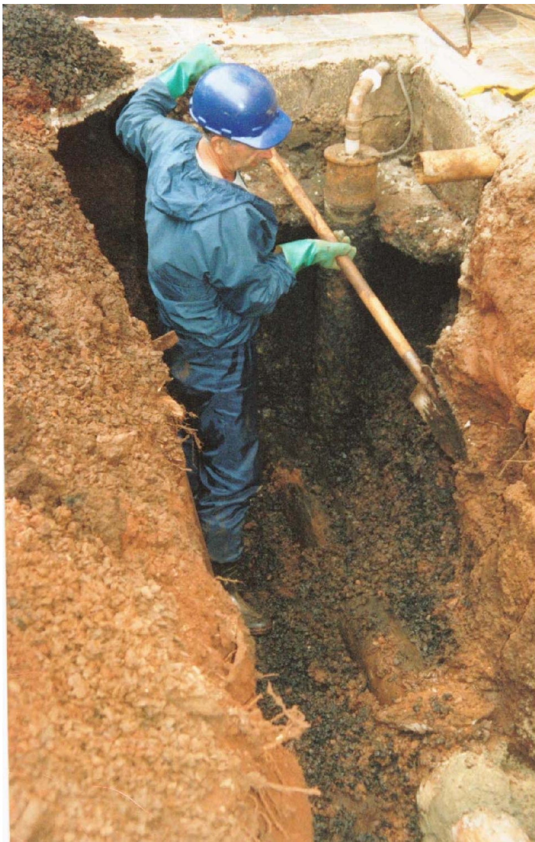
Edifício Bristol – Poço danificado
