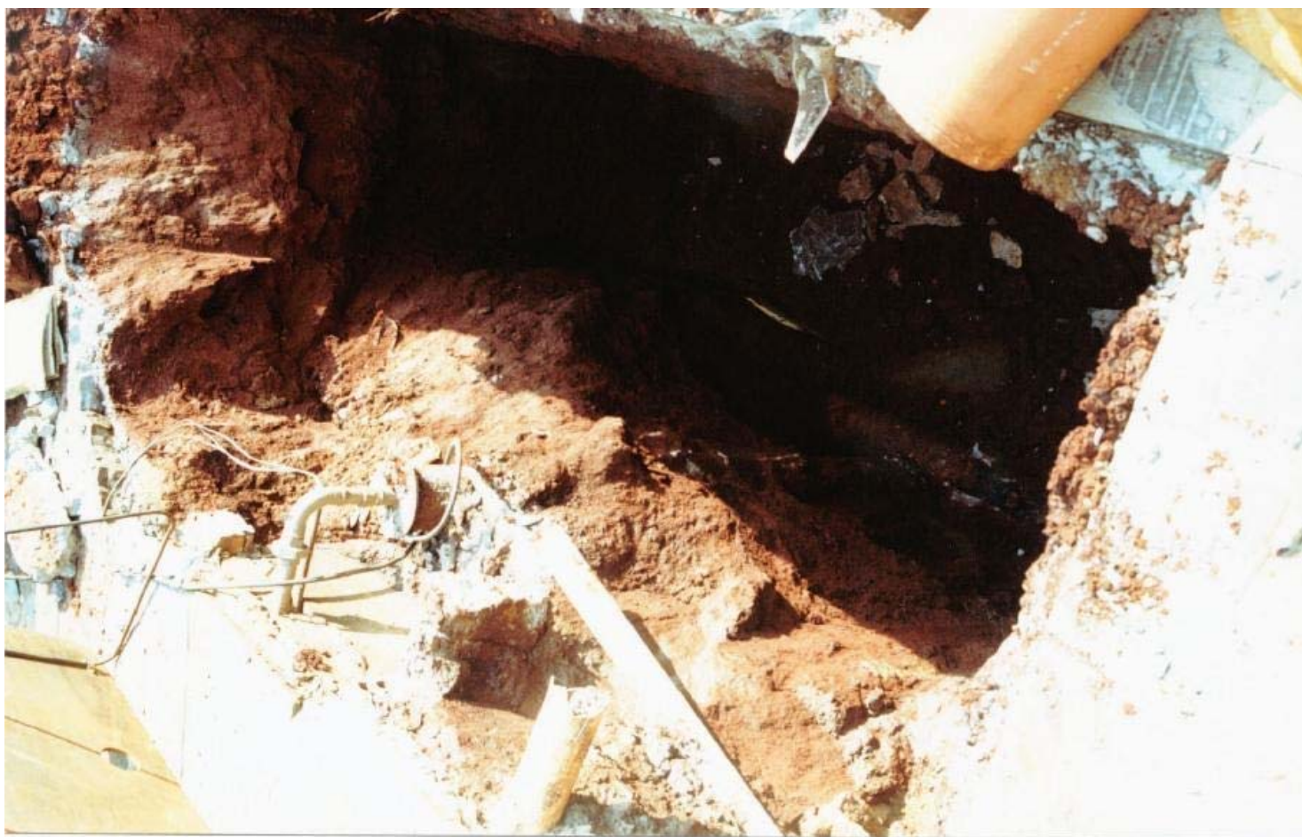
Edifício Tocha – Poço danificado
