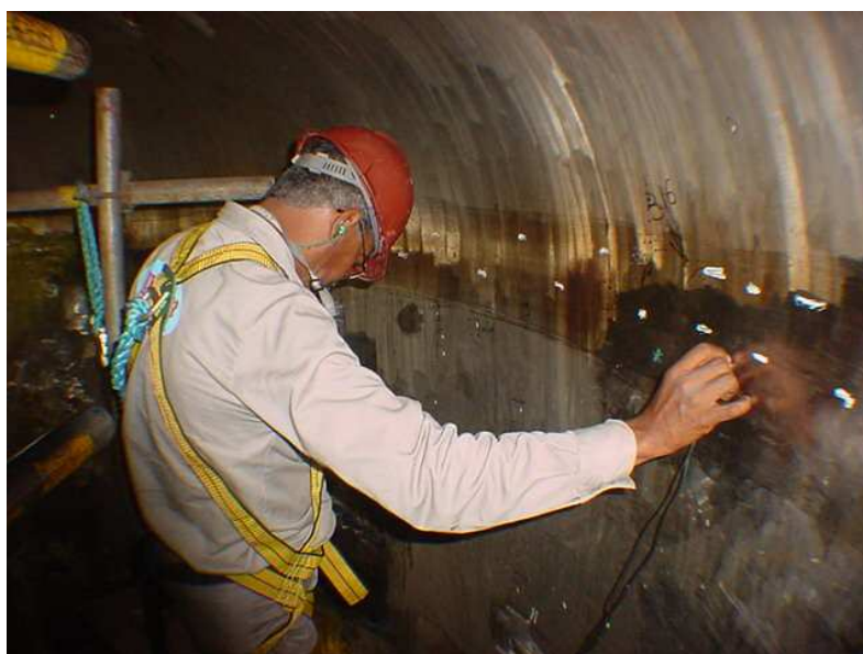
Figura 4.47: Detalhe da realização do ensaio de ultra som após recuperação de pites
