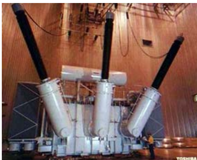
Figura 2-2 - Transformador de potência - 213 MVA - 525 kV - 18 kV (Toshiba, 2004)
