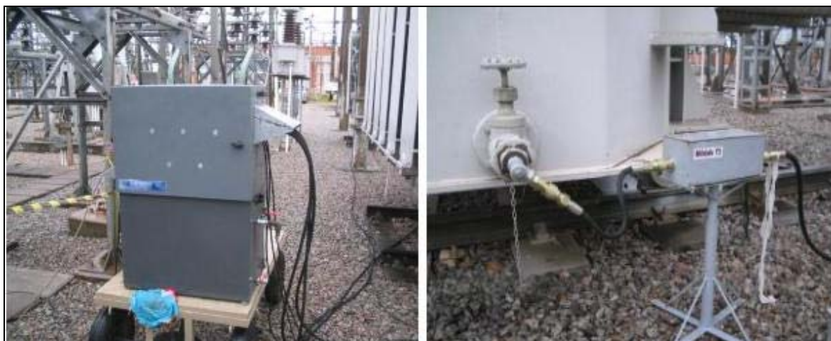
Figura 6-1 - Protótipo MAGO instalado na SE Coqueiros
