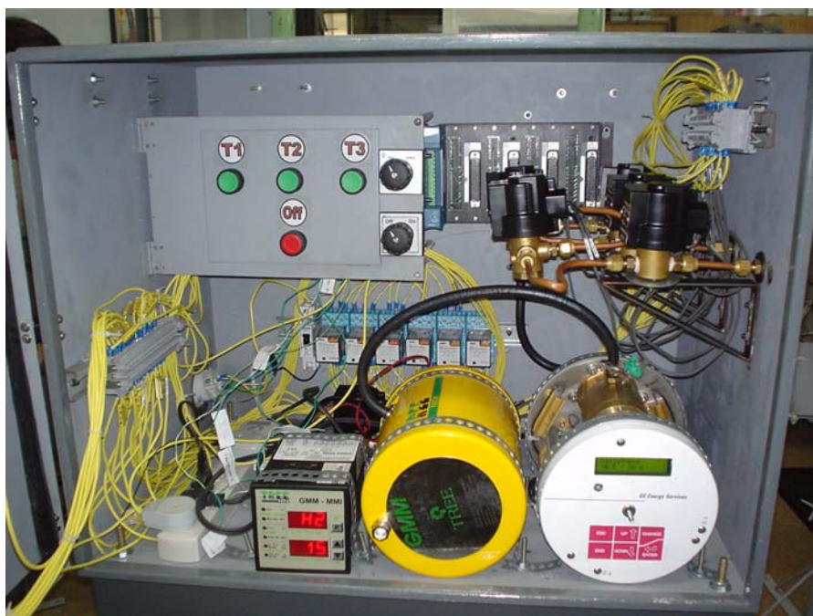
Figura 5-7 - MAGO vista interna como construído
