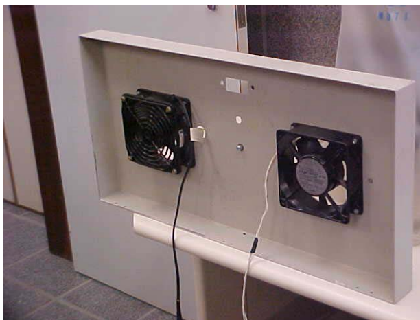
Figura 32. Posição dos ventiladores.
