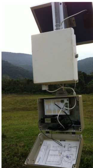
Figura 12: Datalogger, caixa com a bateria e painel solar.
