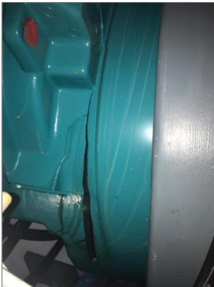
Figura 28: Exemplo de dano secundário causado pela falha no estágio planetário
