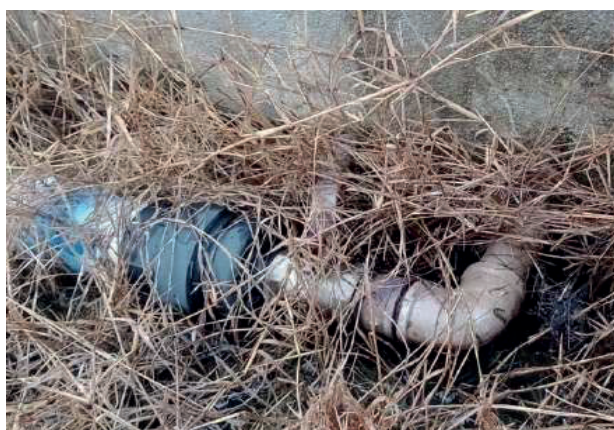
Figura 10. Vazamento de efluentes oleosos no solo a partir do dreno de água pluviais.
