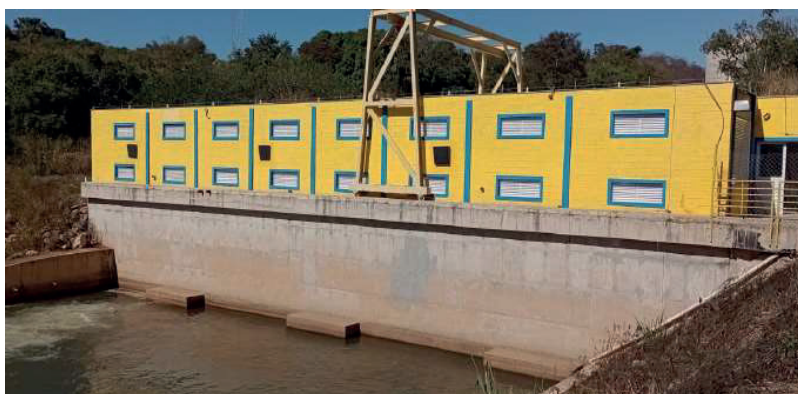
Figura 1. Usina hidrelétrica (CGH) auditada.
