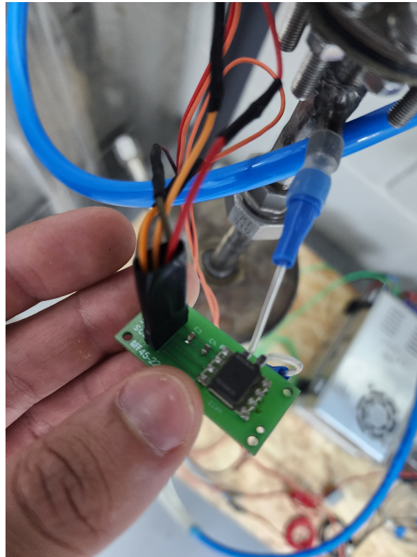
Figura 12 – Sensor de Vazão Instalado
