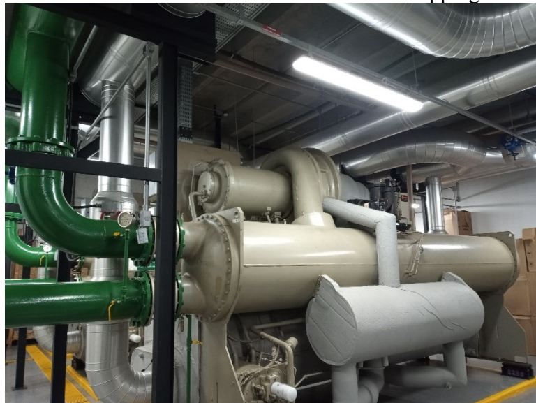
Figura 27 – Foto do sistema de HVAC instalado no Shopping Center.
