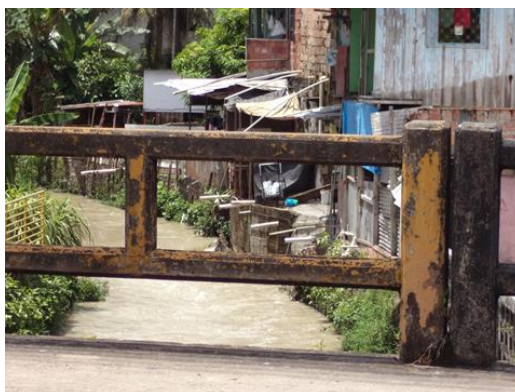
Figura 4: Ocupação em margem de curso d'água, com direcionamento de águas servidas para o curso d'água. Fonte: Miranda e Ferreira, 2018.
