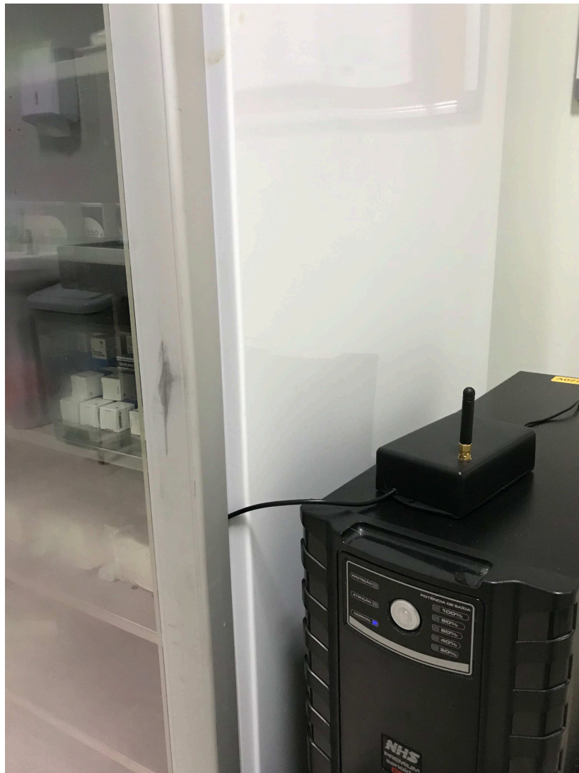
Figura 32 – Instalação de End Device 2 na câmara de vacina do setor Ambulatório.
