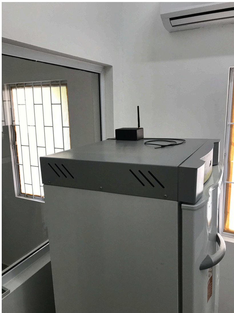
Figura 31 – Instalação de End Device 1 no setor da farmácia.
